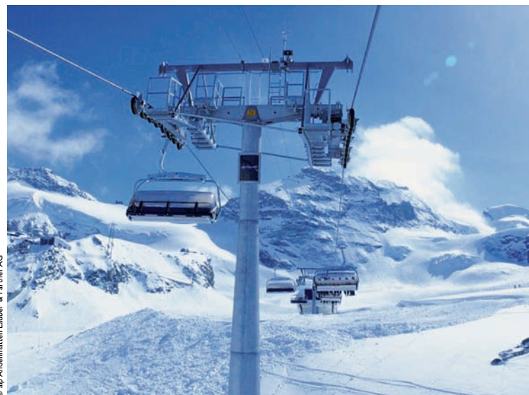
Télesiège Morenia à Saas-Fee : alp a été chargée de la conception et de l'exécution des travaux.
